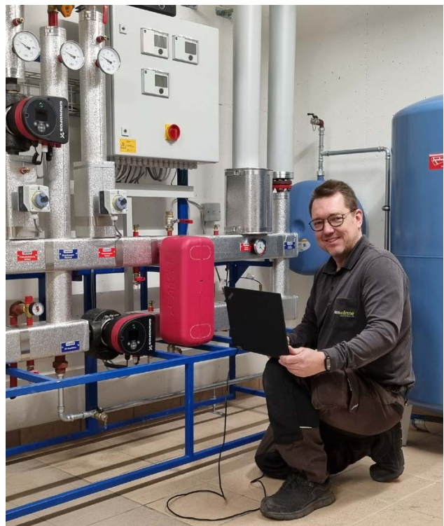
Jens Hoppe bei Servicearbeiten
