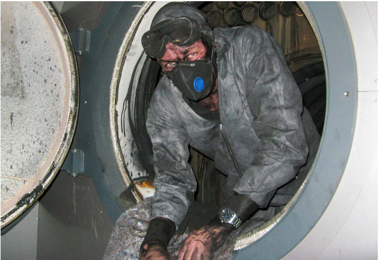
Innenreinigung des Kessels vor Prüfung
