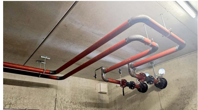
Leitungsführung an der Decke der Tiefgarage
